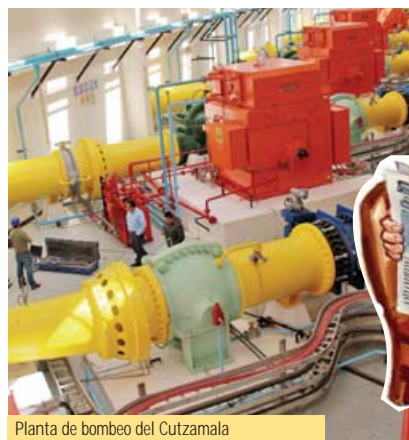
Planta de bombeo del Cutzamala
